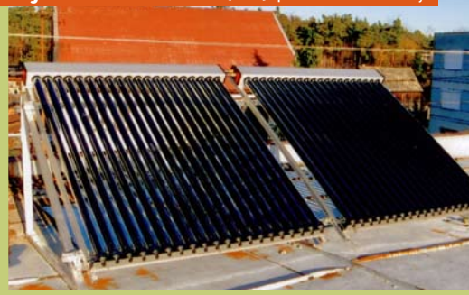
Šajdíkové Humence (SR) | solární kolektory
